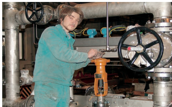
Markus Bergelt (Mechatroniker im 3. Ausbildungsjahr) bei Montagearbeiten an einer Ölversorgungsanlage für Turboverdichter. Foto: IHK
